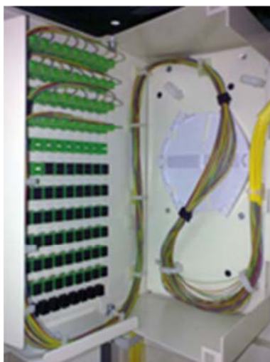
Panneaux de brassage et Câbles breakout
